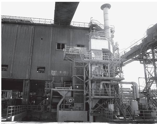
写真 5 COURSE50 スラグ顕熱回収設備の外観写真
